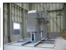
◇ 海水ポンプモータ保管状況
