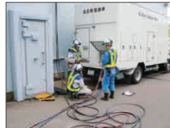
◇高圧発電機車による電源供給
