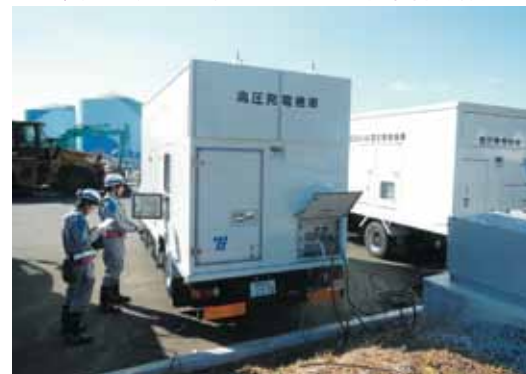
◇高圧発電機車による電源確保訓練
