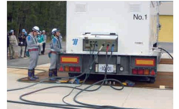
移動式大容量発電機を使った電源供給訓練を実施
