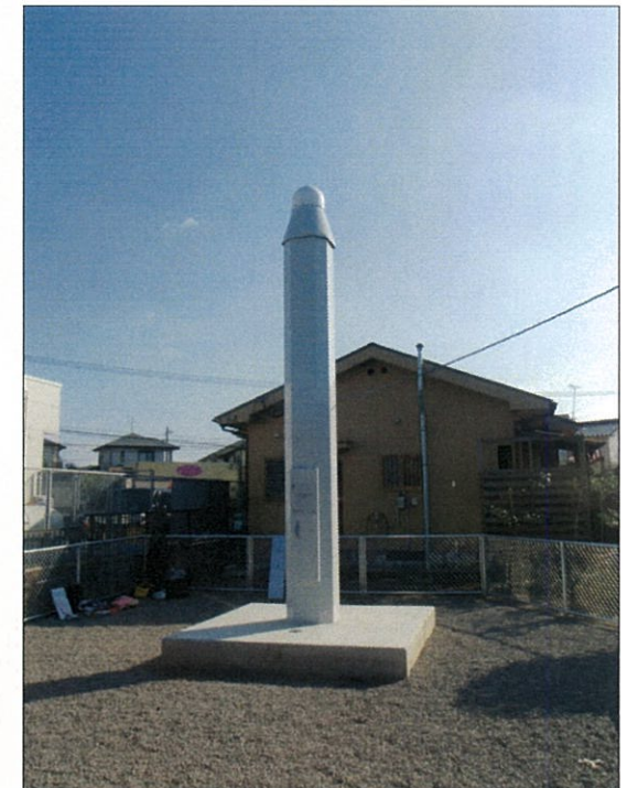
吉野町の機器設置状況
