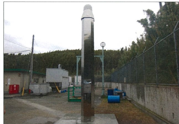
竹島の機器設置状況
