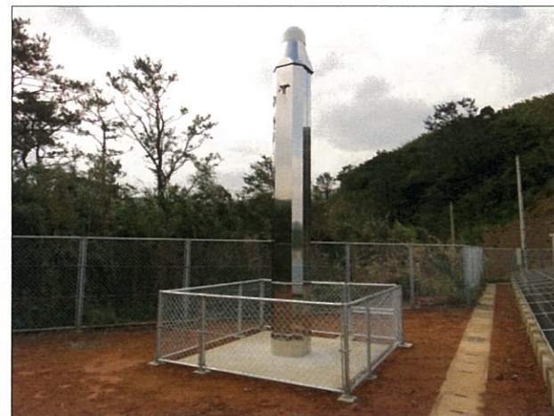
黒島の機器設置状況
