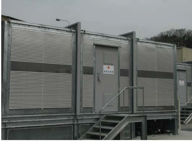
蓄電池収納建屋写真
