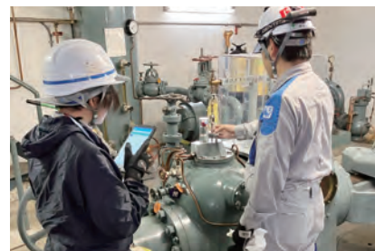
設備保全業務のうち、基本2人1組で行う巡視業務
