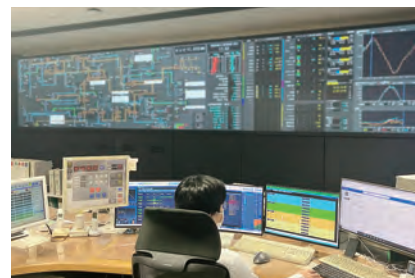
時々刻々と変化する電気の使用量に応じて発電量の調整を行い、良質な電気を届けている。
