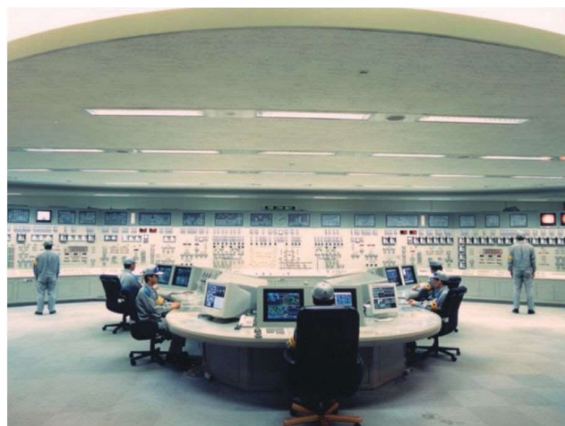
[火力発電所での常時監視]
