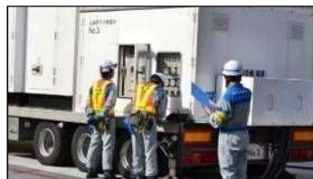
高圧発電機車による電源供給
