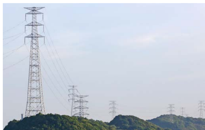
500kV 苓北火力線（九州一高い鉄塔〔高さ195m〕）
