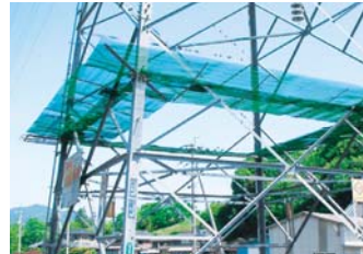
昇塔防止装置
