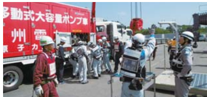
移動式大容量ポンプ車の設置
