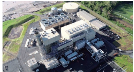
アメリカ バースボローガス火力発電所 (2019年5月営業運転開始)
