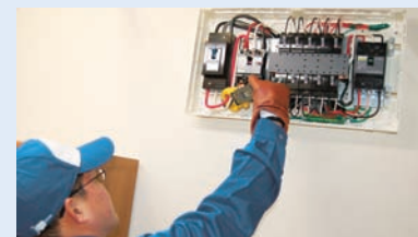
分電盤の点検
