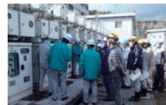
GISの日常点検等の研修会 [佐賀送配電統括センター]
