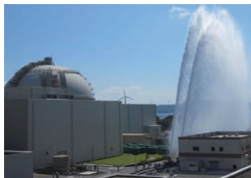
◇放水砲による放水
