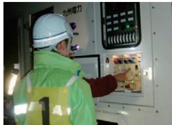
◇高圧発電機車による電源供給(夜間)
