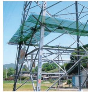
送電鉄塔の昇塔防止装置の設置
