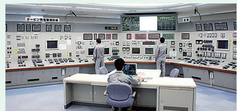
玄海原子力発電所訓練センターシミュレーター室
