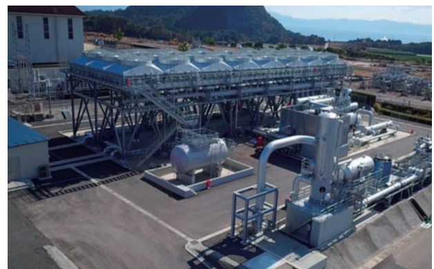
山川バイナリー発電所
