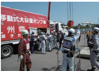
◇移動式大容量ポンプ車の設置
