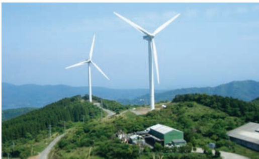
長島風力発電所
