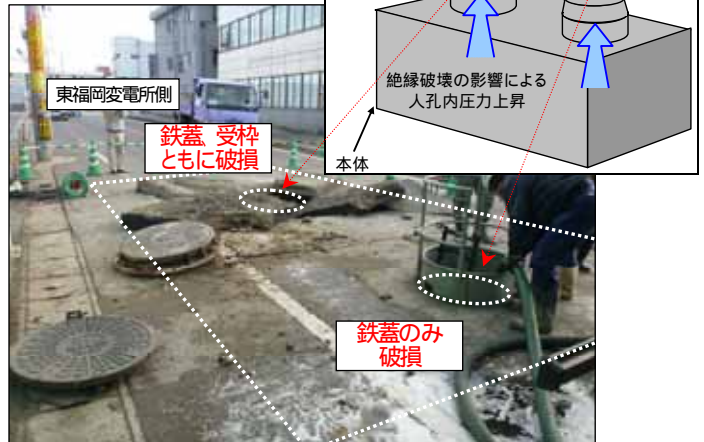
・ 8人孔損壊状況
