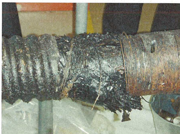
事故箇所(銅管とり除き後)
