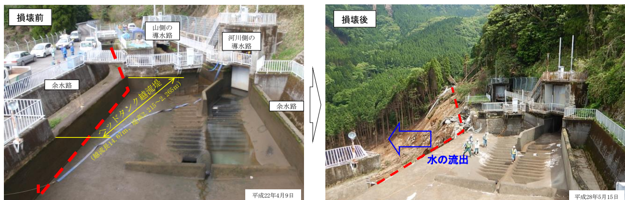
写真－１ 黒川第一発電所ヘッドタンク全景（損壊前〔空虚時〕、損壊後）
