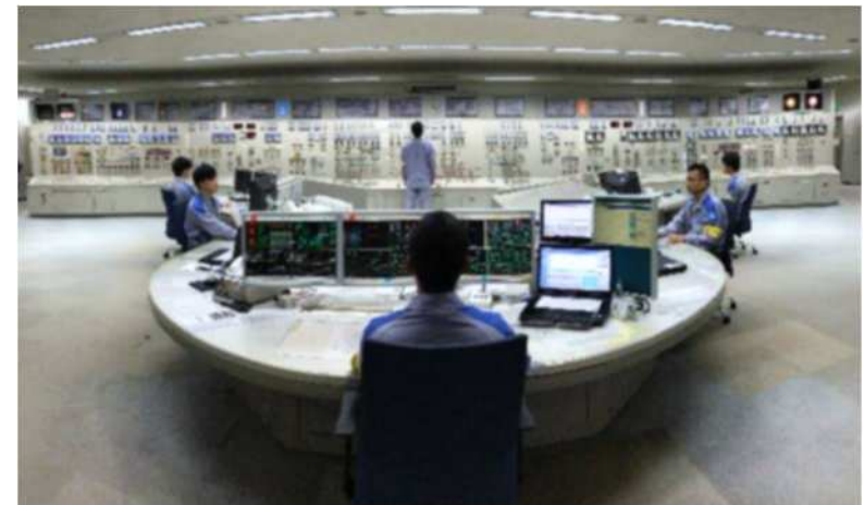
〔火力発電所での常時監視〕
