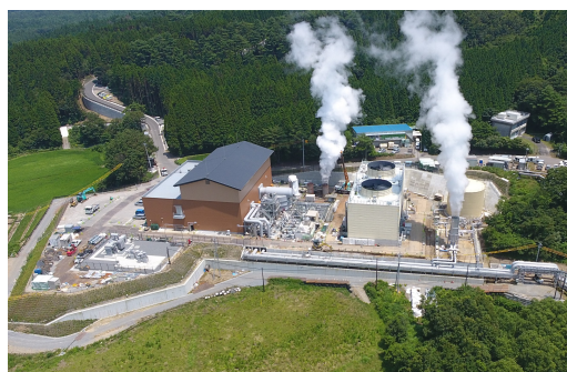
【更新後の大岳発電所（8月現在）】
