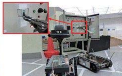
制御盤を開放しスイッチ操作
