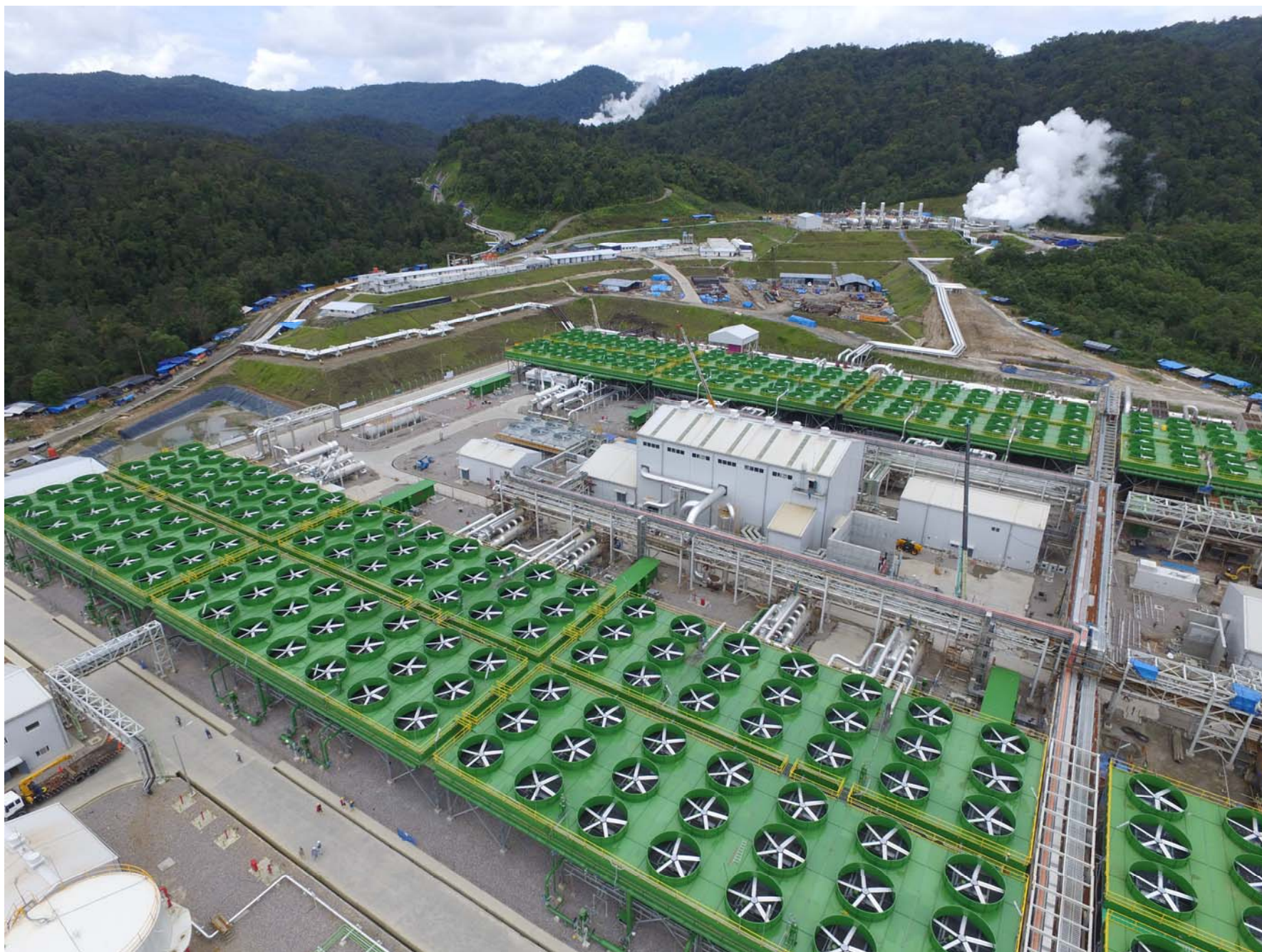
インドネシア・サルーラ地熱 I P P プロジェクト 2 号機
