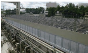
海水ポンプエリア竜巻防護対策
