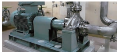
常設電動注入ポンプ
