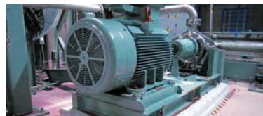
常設電動注入ポンプ
