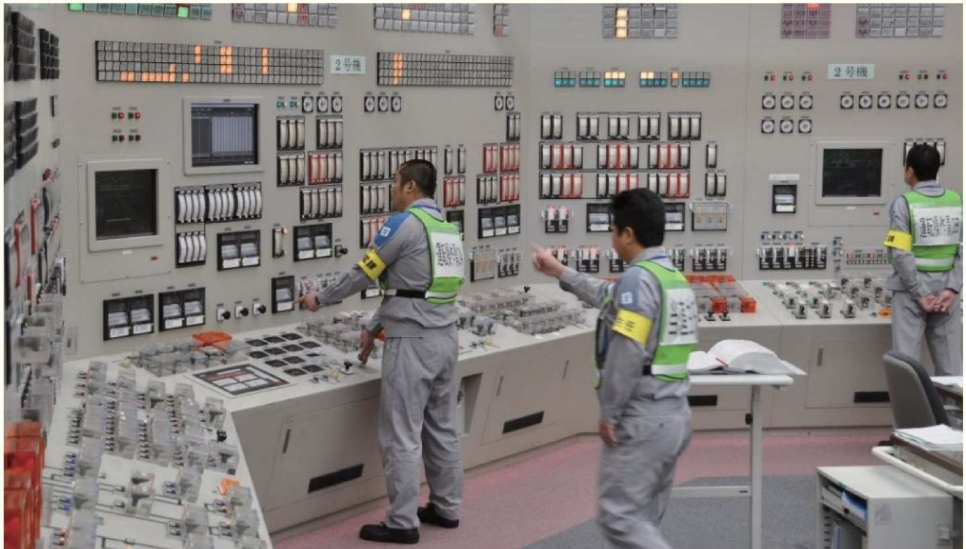
[中央制御室(2号機原子炉起動時)]
