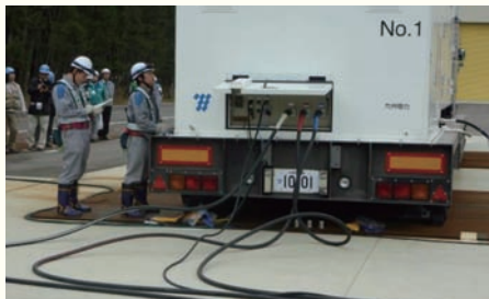
移動式大容量発電機を使った電源供給訓練
