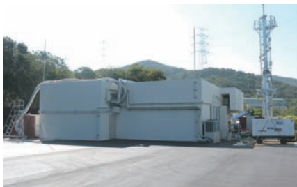
緊急時対策所の設置
