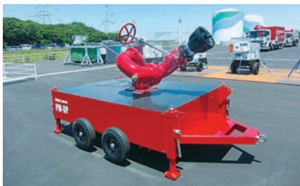
放水砲の配備
