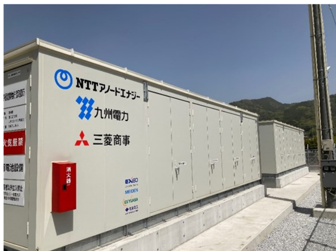
【福岡県田川郡に設置した蓄電システム】
