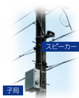
電柱への設置状況
