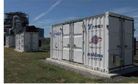
2022年8月に運用を開始した蓄電池「大牟田蓄電池所」(福岡県)
