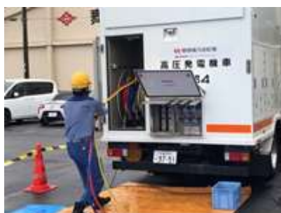
第八管区との電源供給訓練
