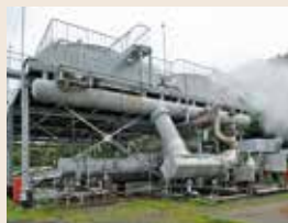
八丁原バイナリー発電所
