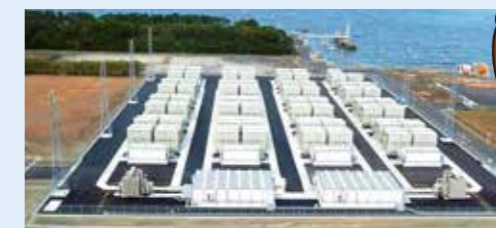
大容量蓄電システムを備えた豊前蓄電池変電所(福岡県豊前市)
