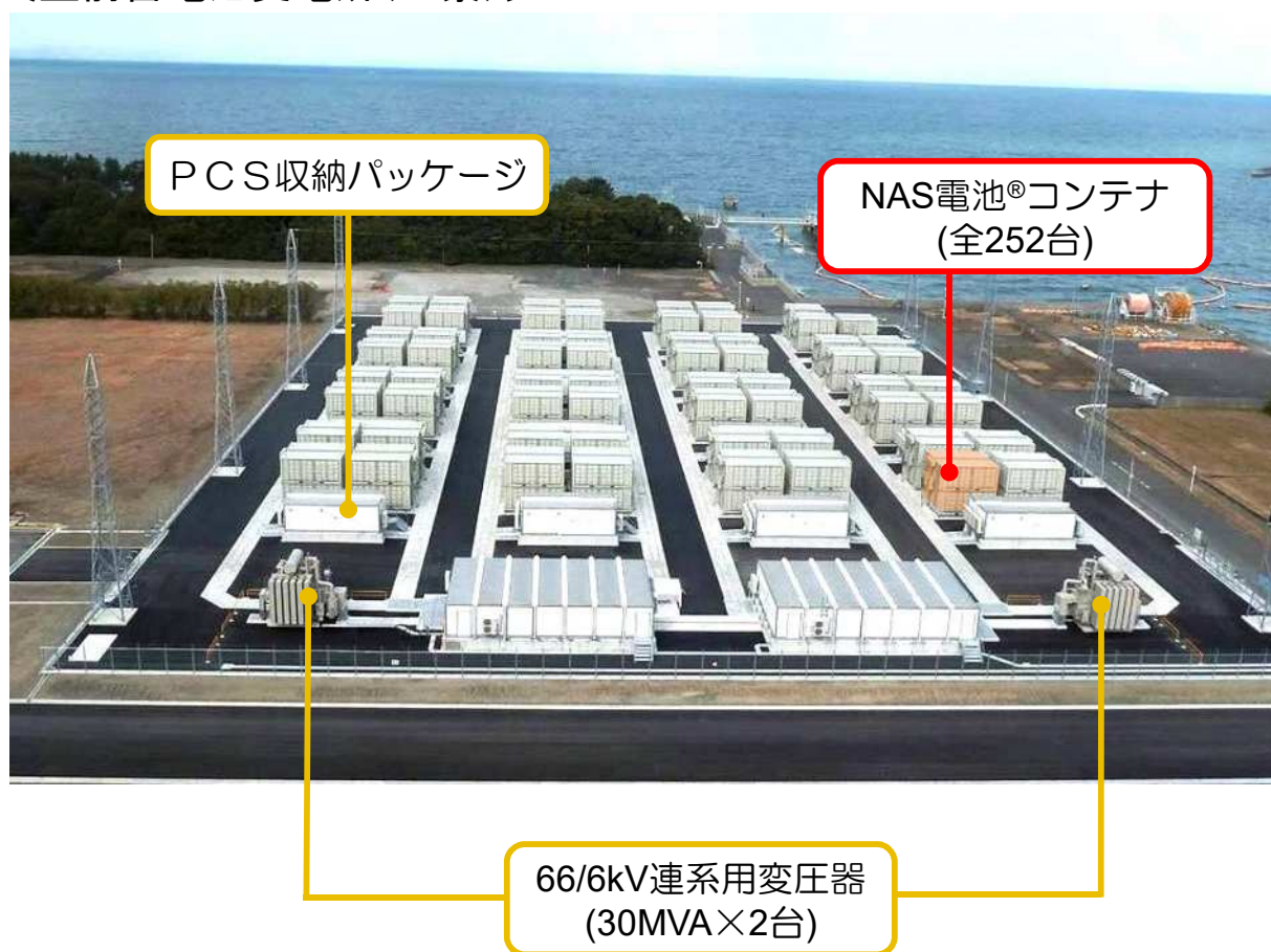
〔豊前蓄電池変電所（全景）〕
