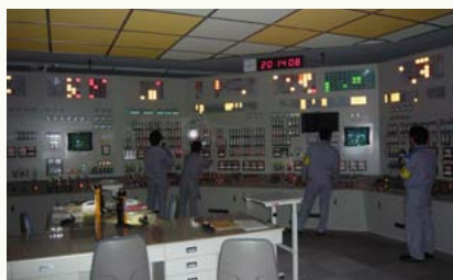
全交流電源喪失訓練
