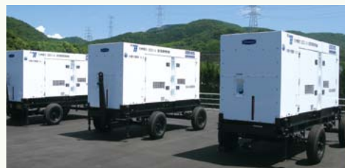
直流電源用発電機(可搬型代替電源)
