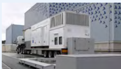
大容量空冷式発電機(交流)
