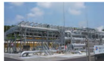
菅原バイナリー発電所
