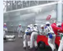
放水砲の設置
