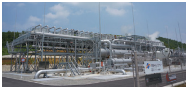
菅原バイナリー発電所
