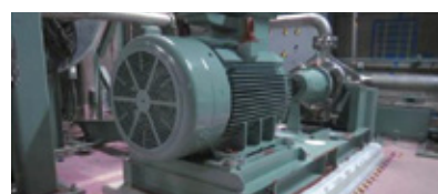
常設電動注入ポンプ
