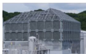
屋外タンクの竜巻防護ネット
