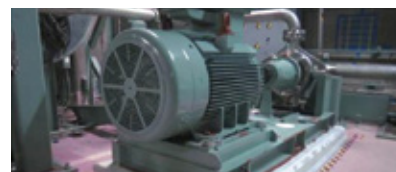
常設電動注入ポンプ
