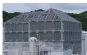
屋外タンクの竜巻防護ネット
