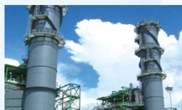
ベトナム初の外資による IPP 事業「フォーミー発電所3号プロジェクト」(ベトナム)
