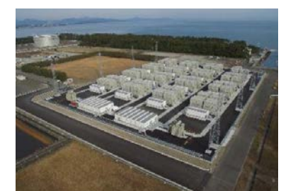
豊前蓄電池変電所
