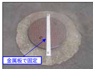
マンホールふたの飛散防止対策
