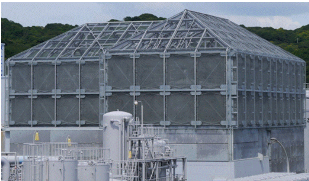
屋外タンクの竜巻防護ネット
