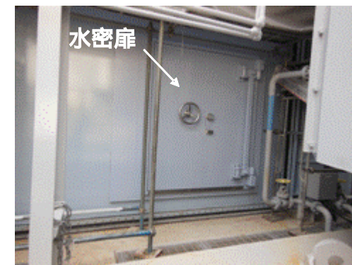
海水ポンプエリア内の水密扉
