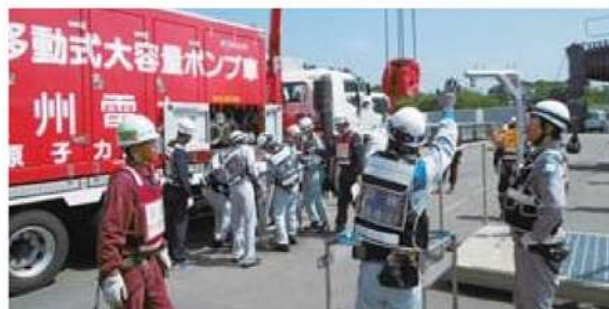
移動式大容量ポンプ車の設置
