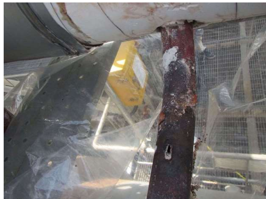
蒸気漏れ箇所付近の配管外面
