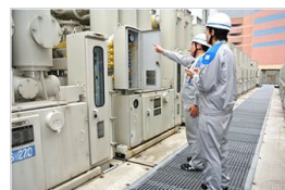
水力発電・変電設備の巡視
