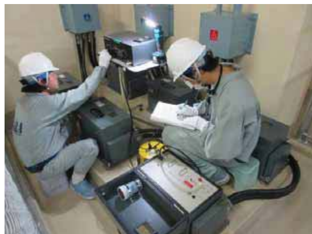
原子炉停止用地震計点検
