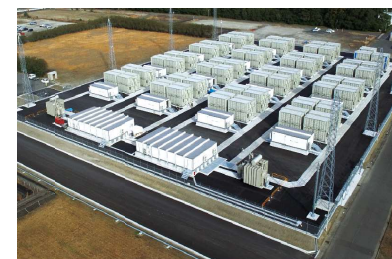
豊前蓄電池変電所
