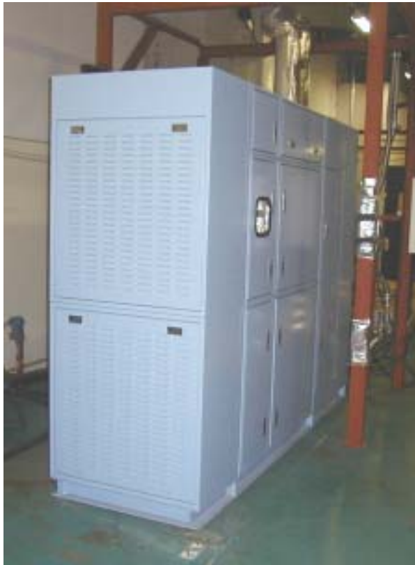
( 参考 1 ) マイクロガスタービンを用いたコージェネレーションパッケージの外観
