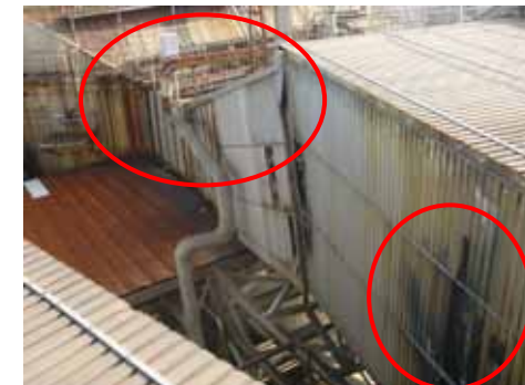
〔腐食・劣化状況〕
