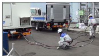
高圧発電機車による電源供給
