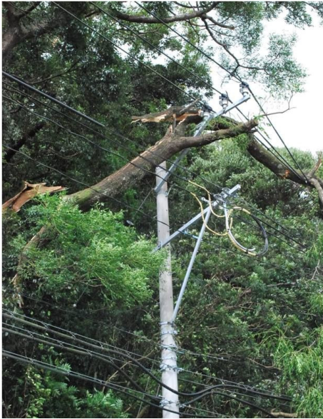
倒木による配電線被害
