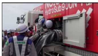
移動式大容量ポンプ車の設置
