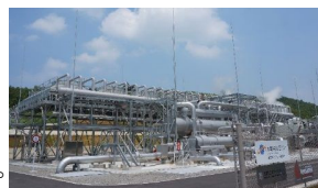
菅原バイナリー発電所
