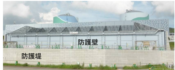
海水ポンプエリアの津波対策の概観
