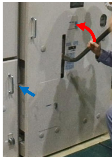
【しゃ断器押し込み操作】
