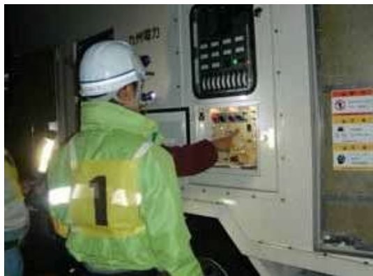
◇高圧発電機車による電源供給(夜間)
