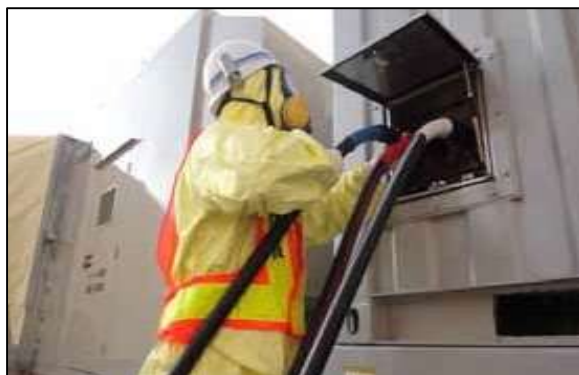
◇中容量発電機車の電源ケーブル接続 (汚染防護具着用)
