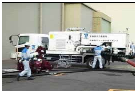
◇可搬型ディーゼル注入ポンプの設置
