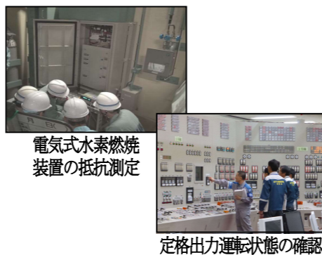
(平成27年 川内原子力発電所使用前検査)
