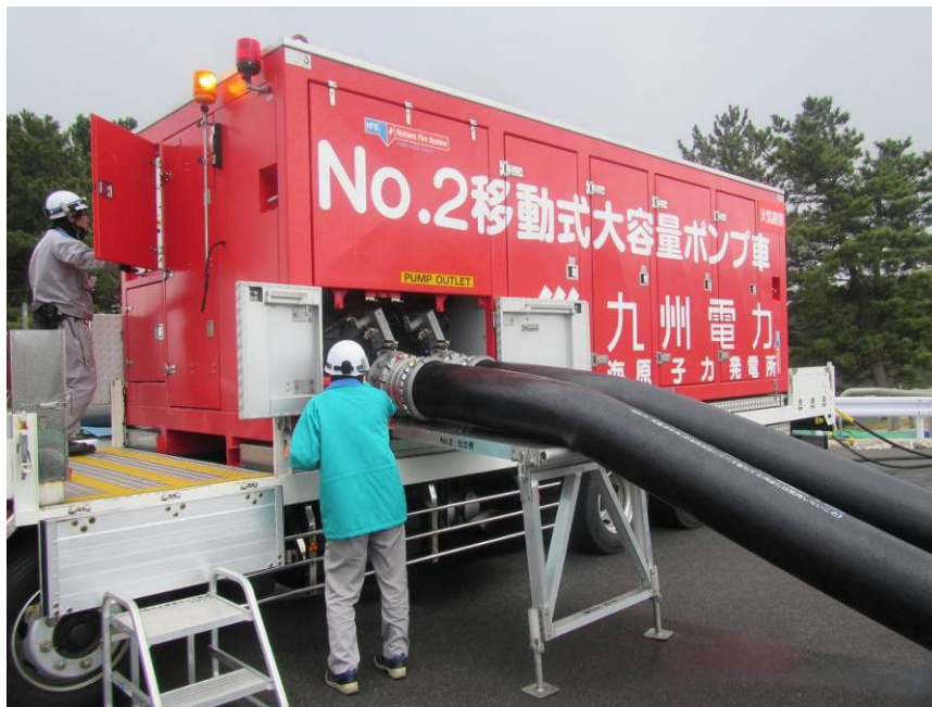
バックアップ設備点検(移動式大容量ポンプ車)
