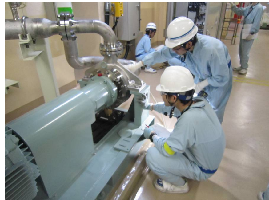
バックアップ設備点検(常設電動注入ポンプ)
