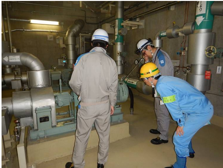
運転中機器の点検
