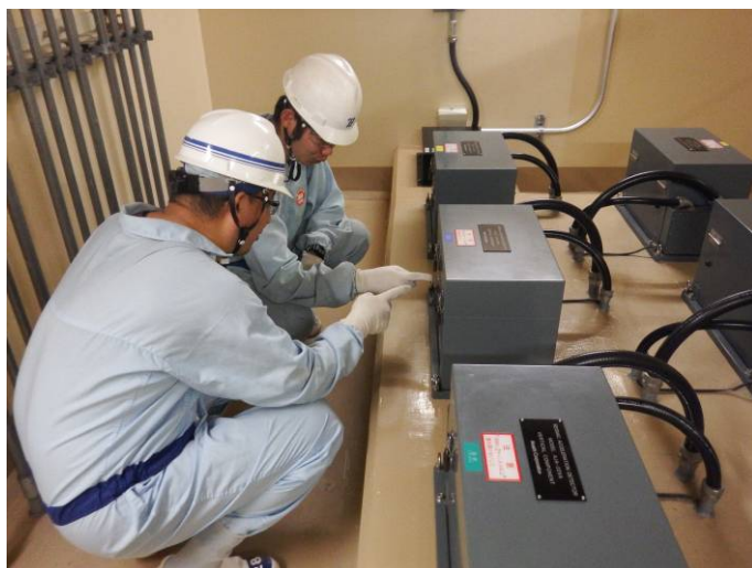
原子炉停止用地震計点検
