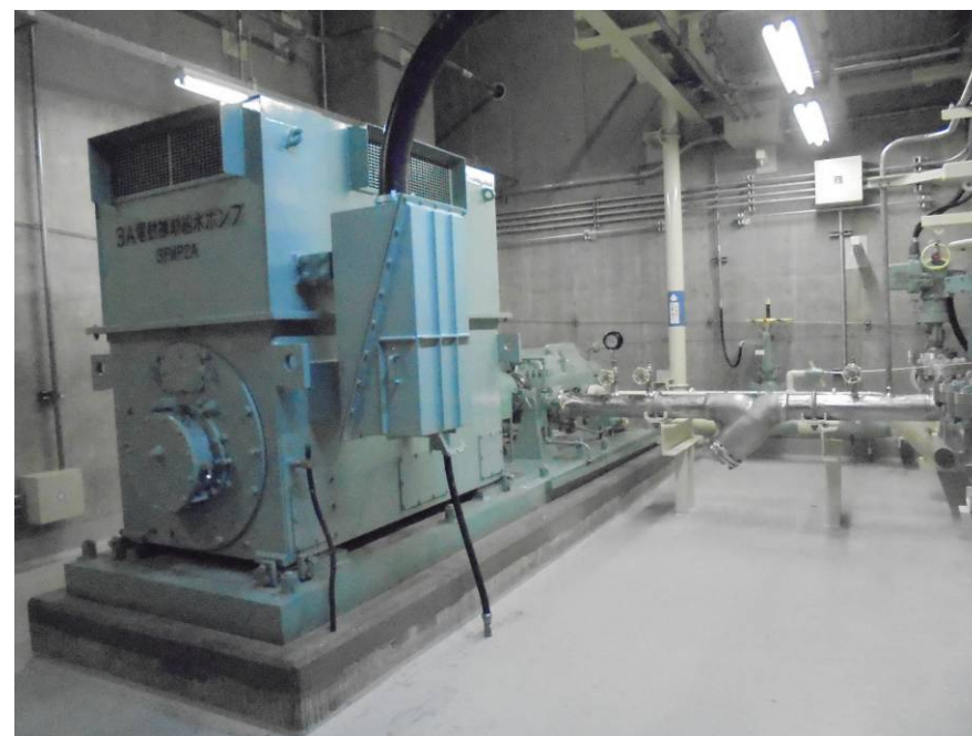
電動補助給水ポンプ作動試験
