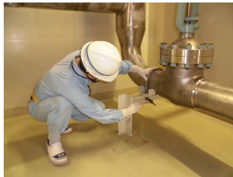
支持装置点検
