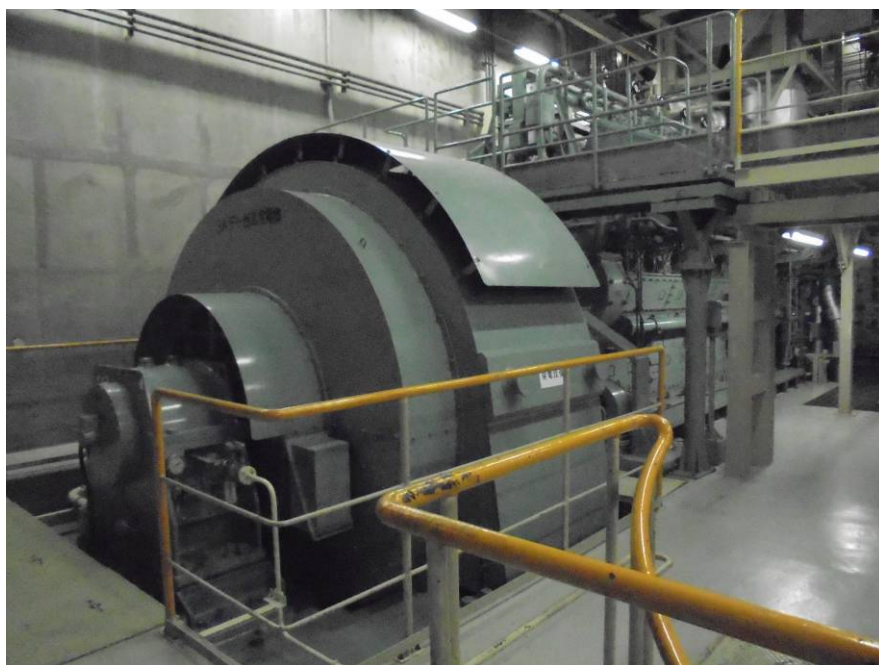
非常用ディーゼル発電機作動試験
