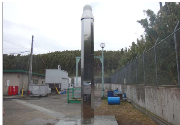
竹島の機器設置状況
