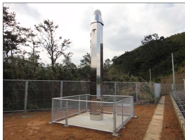
黒島の機器設置状況
