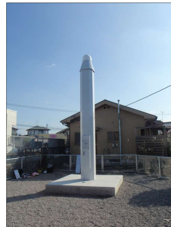
吉野町の機器設置状況
