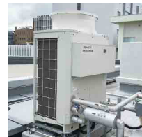
熱源機 消費電力:3P200V 9.43kW
