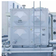
貯湯槽 4m³(有効2.5m³)
